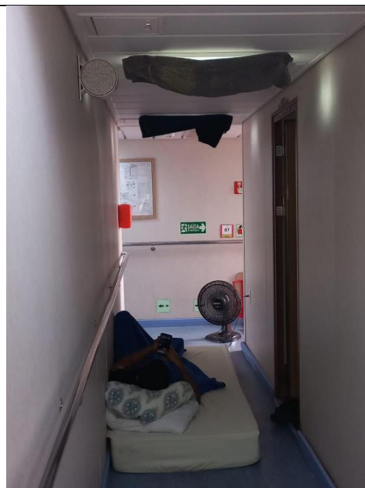
Ar condicionado inoperante
